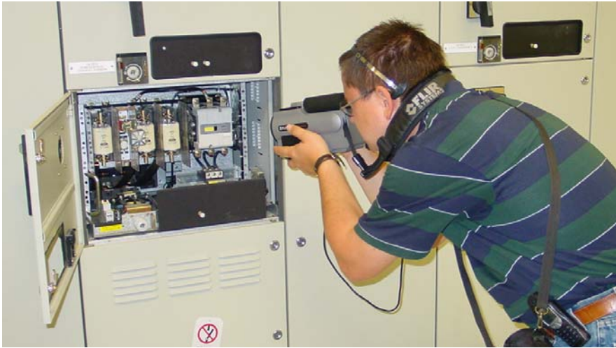
Elektrothermografie: In diesem Bereich sind speziell ausgebildete Experten gefragt.
