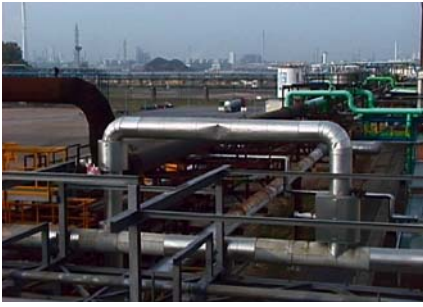
Thermografische Isolationsprüfung erforderlich: Rohrleitung in einem Chemiebetrieb mit erkennbarer mechanischer Schädigung.
